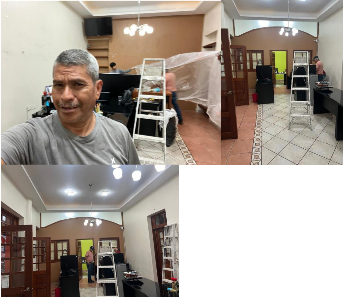
Inspección de pintura en oficinas de la presidencia municipal.
